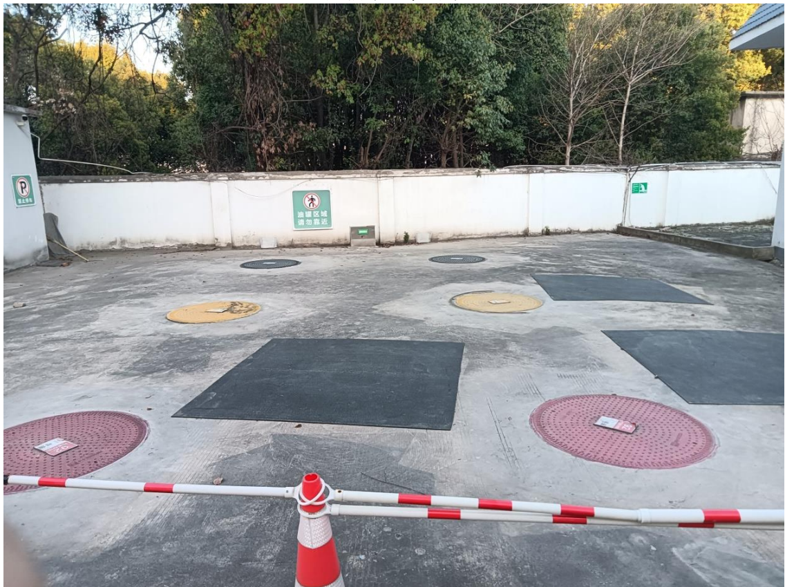
加油站罐区照片
