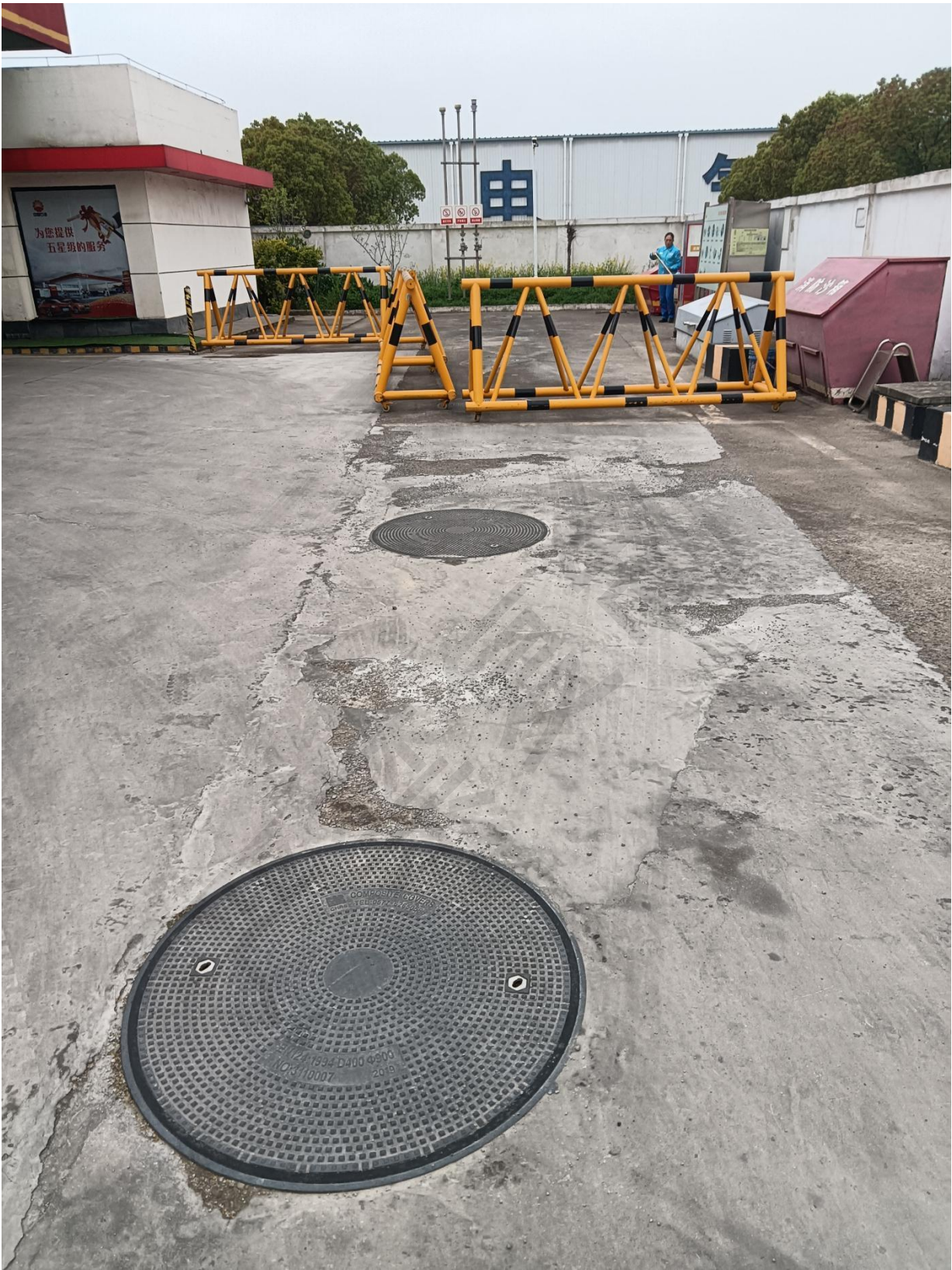
图 2-10 加油站罐区照片
