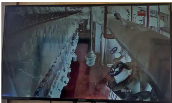
制冷设备间-操作台监控画面
