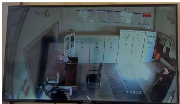
制冷设备控制室监控画面
