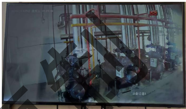
制冷设备间-过道监控画面
