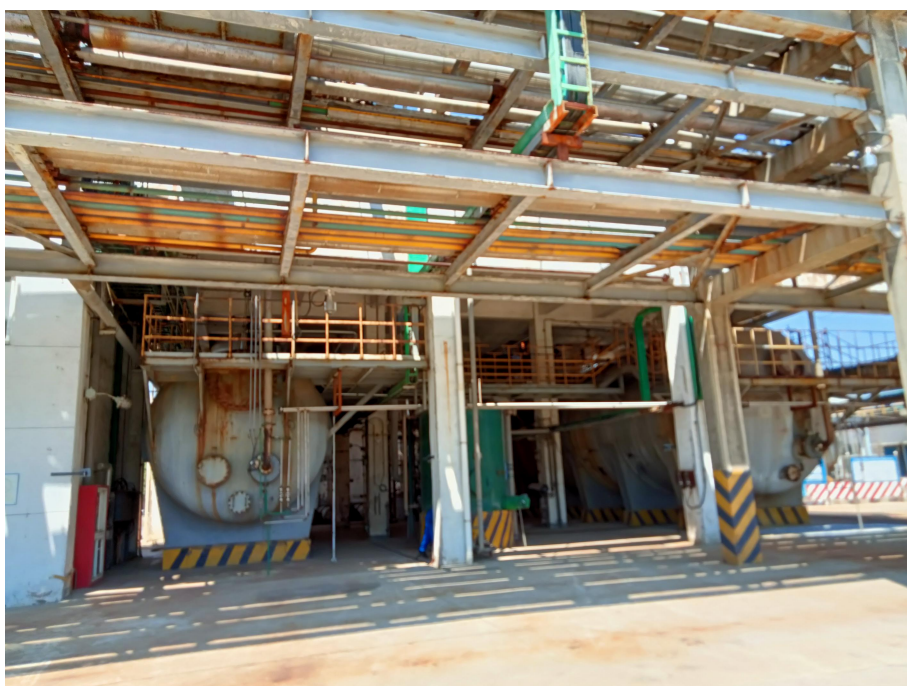
西侧 SO 2 焚烧净化冷凝厂房及罐区
