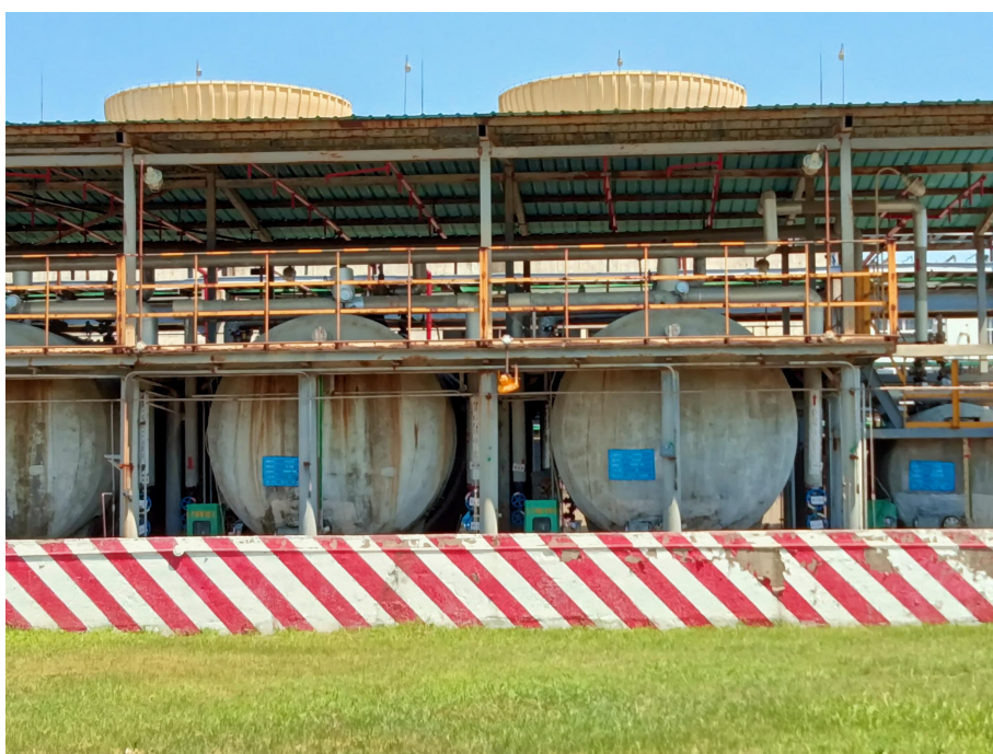
北侧环氧乙烷罐区
