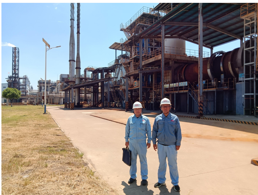
南侧废液/废气焚烧装置
