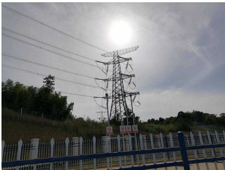
图2-9 西侧架空电力线
